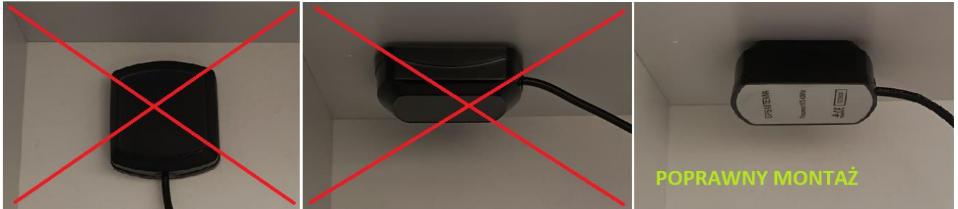
Rysunek 5. Sposób montażu anteny GPS w szafce instalacyjnej
